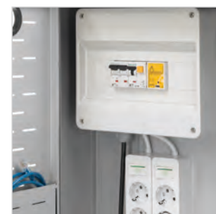
Máxima seguridad eléctrica
